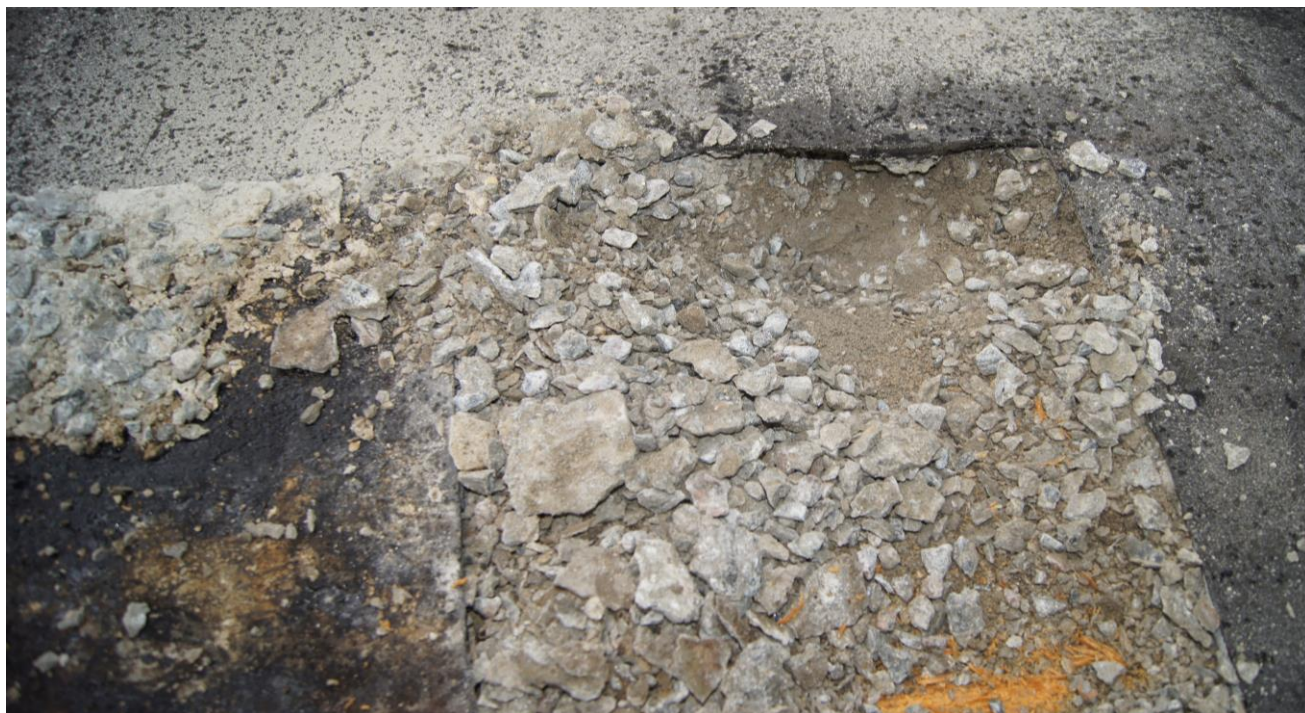
Рисунок 5 - Разрушение слоя легкого бетона на глубину до 100 мм
