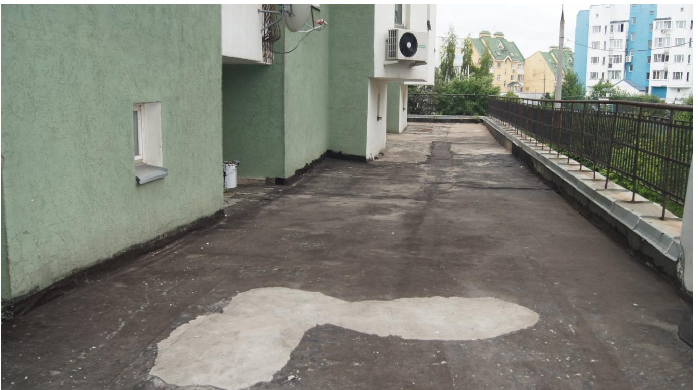
Рисунок 4 - Отслоение и трещинообразование наружного покрытия из рулонного битумно-полимерного покрытия (рубероид)
