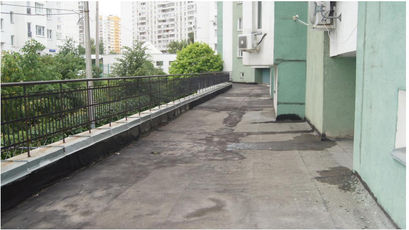
Рисунок 3 - Отслоение и трещинообразование наружного покрытия из рулонного битумно-полимерного покрытия (рубероид)
