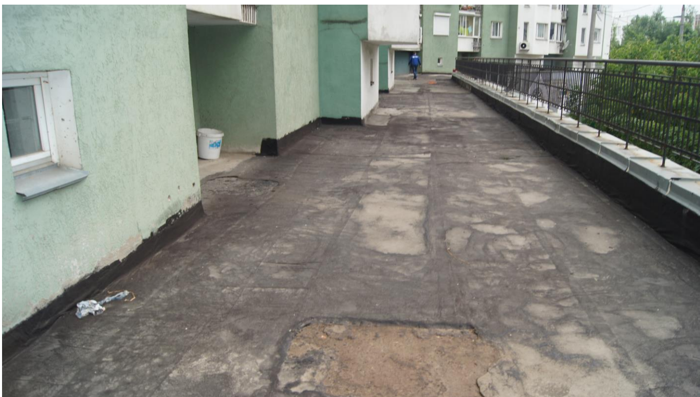
Рисунок 2 - Отслоение и трещинообразование наружного покрытия из рулонного битумно-полимерного покрытия (рубероид)
